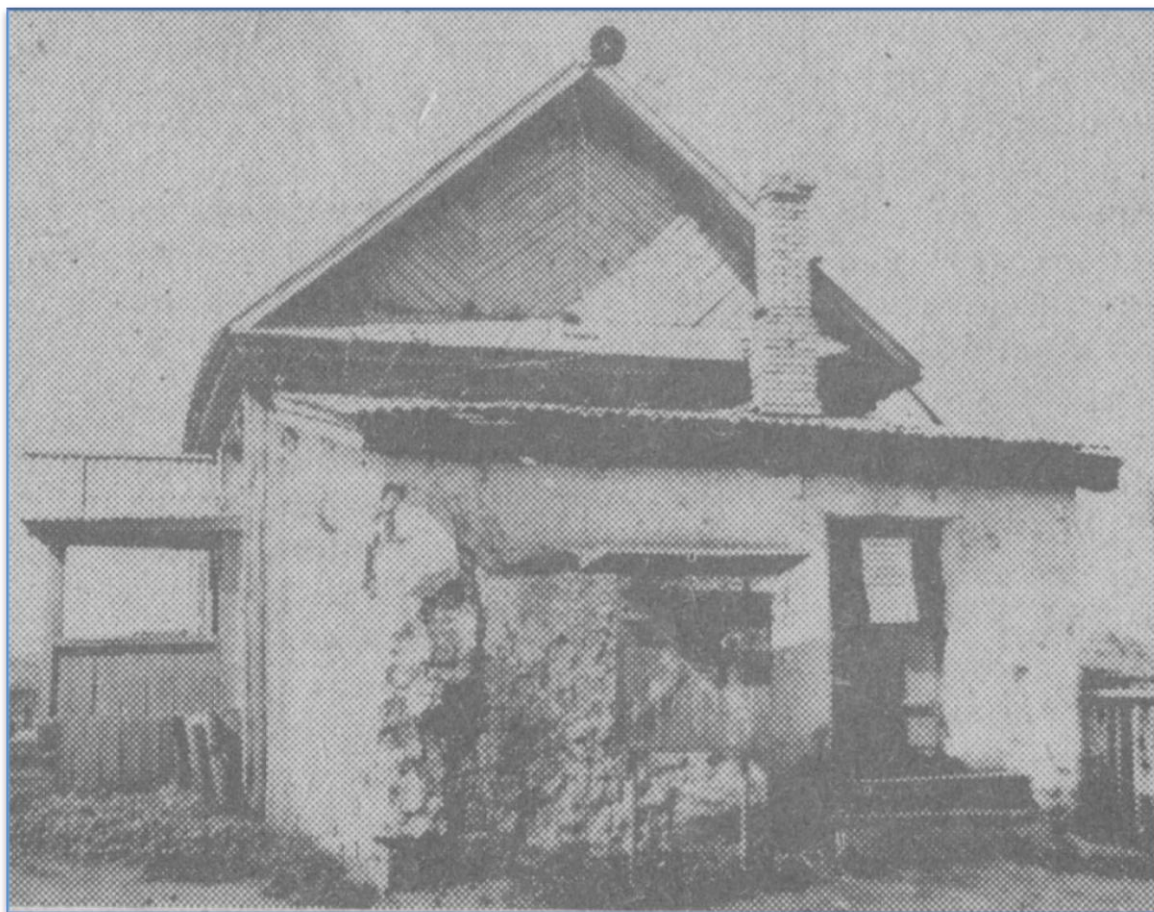
Полуразрушенное здание сельского клуба в д. Иштуганово
